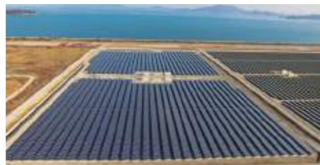
OC東野崎太陽光発電所 (岡山県) OC Higashinozaki Solar Power Plant (Okayama Prefecture)
