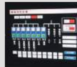
■ タッチパネル(照明用) Touch Panel (for lighting)
