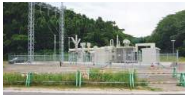
出雲クリーン発電太陽光発電所 (島根県) Izumo Clean Solar Power Plant (Shimane Prefecture)
