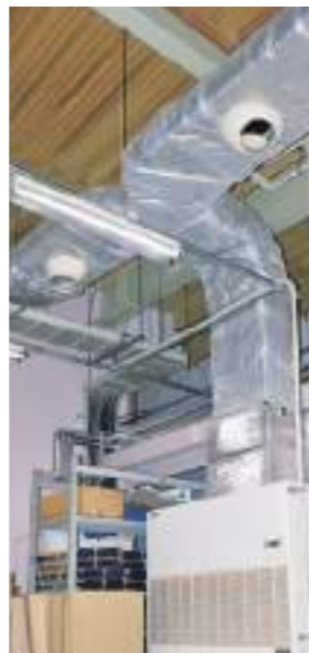
作業ラインのレイアウトに合わせて最適化した空調吹出し Optimized air conditioning exhaust based on the layout of the work line
