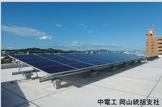
自家消費太陽光発電に蓄電池を組み合わせ、BCPに対応したZEB建築物 ■ 発電容量 : 33kW
