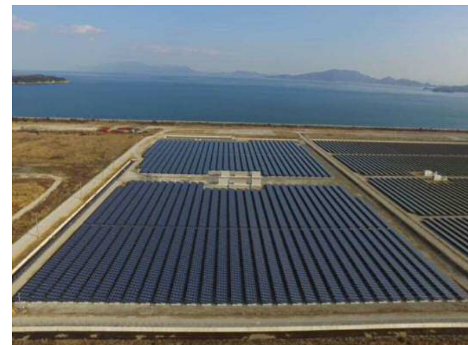
【東野崎太陽光発電所】
