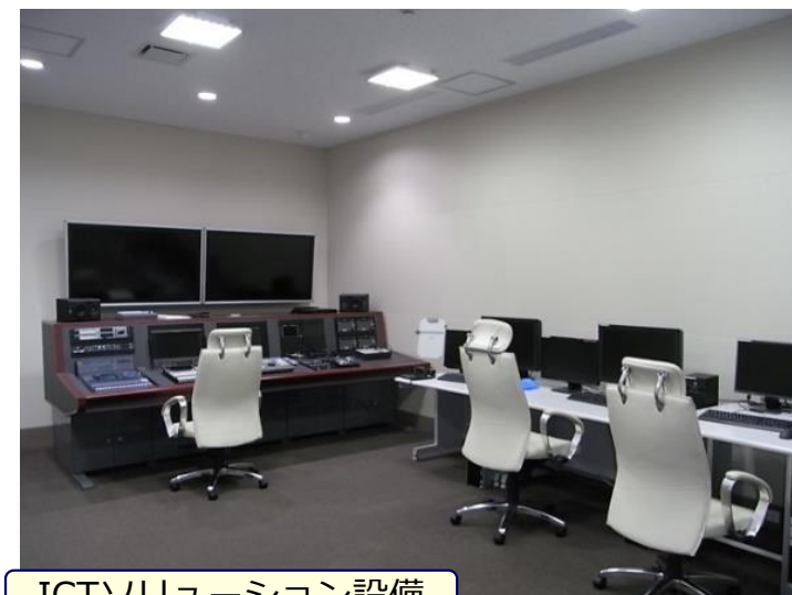
ICTソリューション設備
