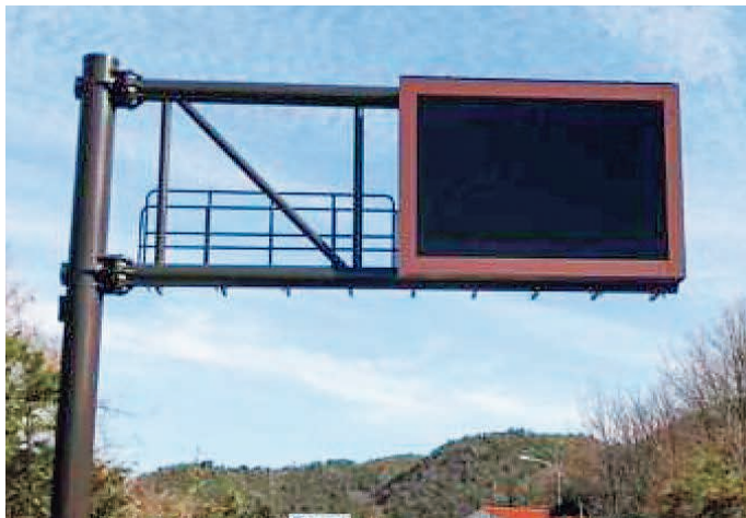
道路・河川情報設備
