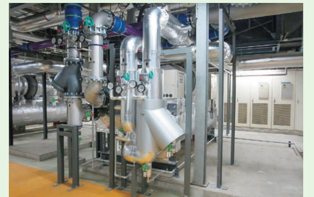
ターボ冷凍機
