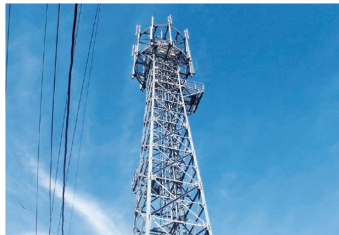
移動体無線通信設備
