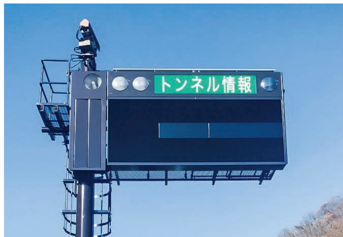
道路・河川情報設備
