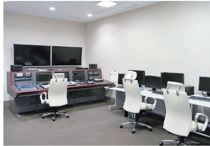
ICTソリューション設備
